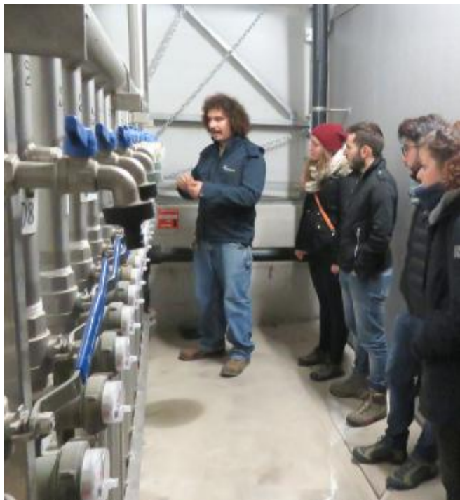
L'impianto per il trattamento durante un sopralluogo
