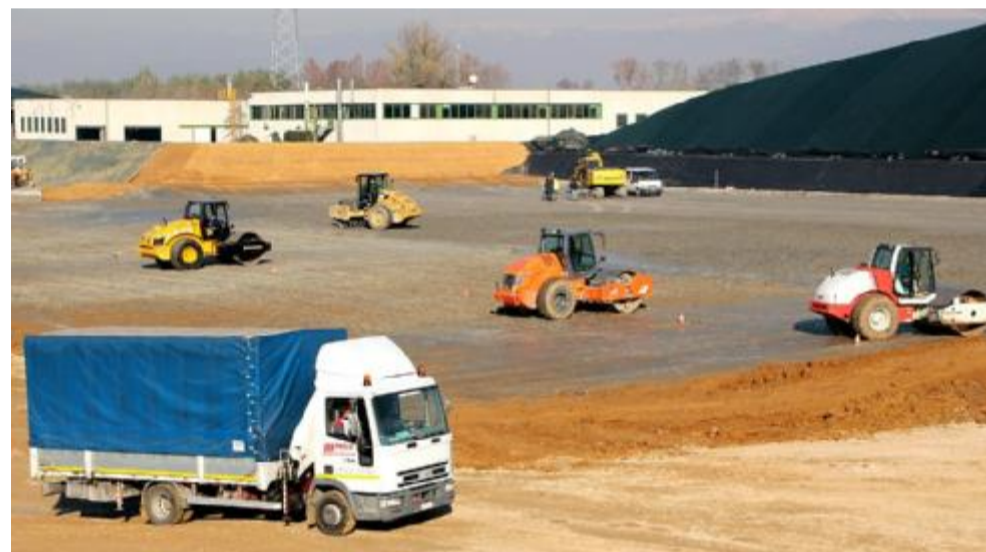
Lavori di preparazione del sottofondo sul quale realizzare la nuova discarica FOTOSERVIZIO AMATO
